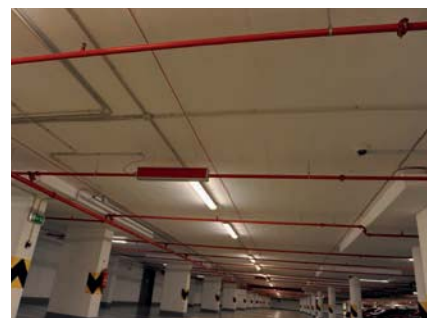
V garážích jsou červeně lakované potrubní rozvody SHZ nepřehlédnutelné. Dobře jsou vidět mechanické spoje potrubí i sprinklerové hlavice.
