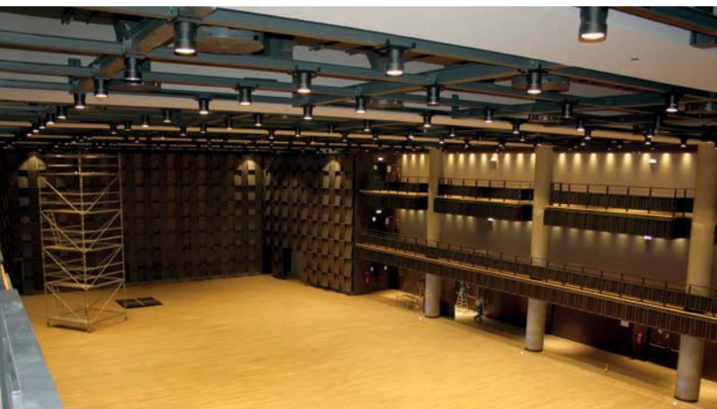
Pohled na ocelový rošt „Rigging“ – celkový náhled
