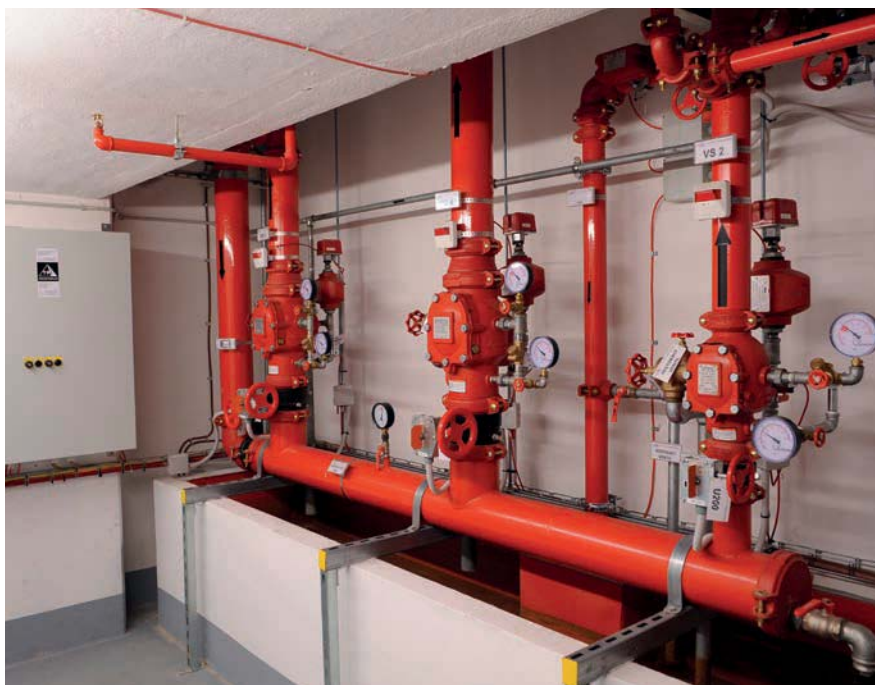
V místnosti řídicích ventilů jsou na horizontálním rozdělovačím potrubí nad záchytnou vanou umístěny tři mokré ventilové stanice Victaulic.
